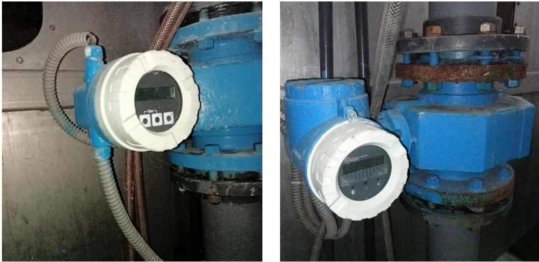
Figura 9. Caudalímetro electromagnético da entrada da liña 1 (esquerda) e caudalímetro electromagnético da entrada da liña 2 (dereita)
