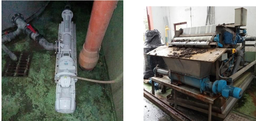
Figura 19. Bomba de lodos a deshidratación (esquerda) e filtro banda (dereita)
