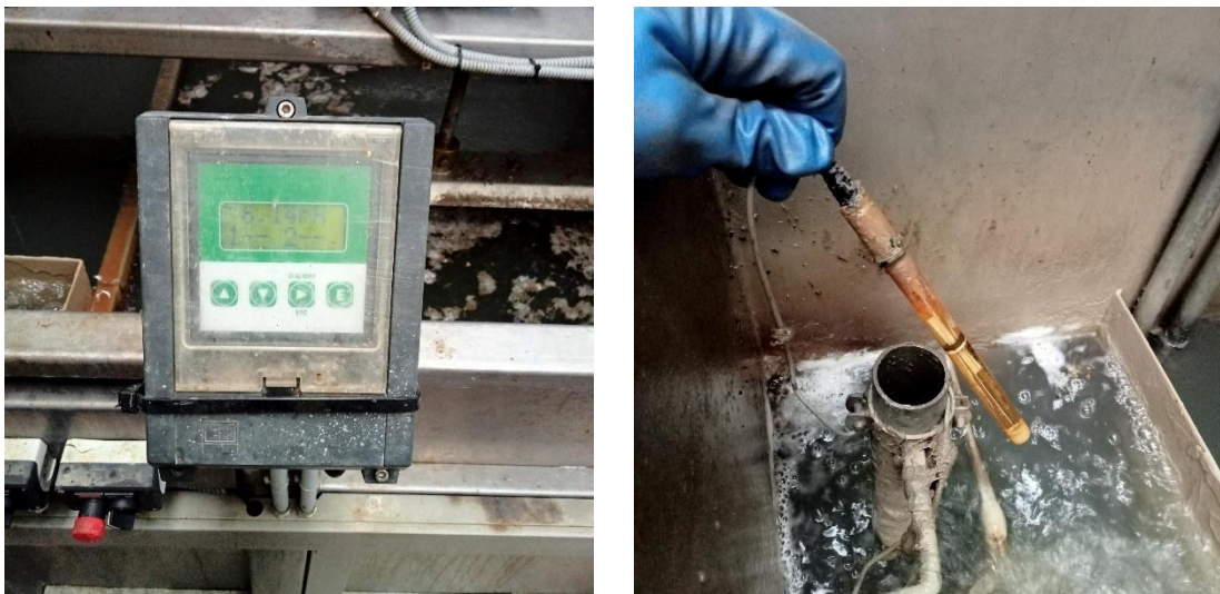
Figura 10. Medidor de pH na entrada da liña (esquerda) e sonda de pH en punto de rotura de carga (dereita)
