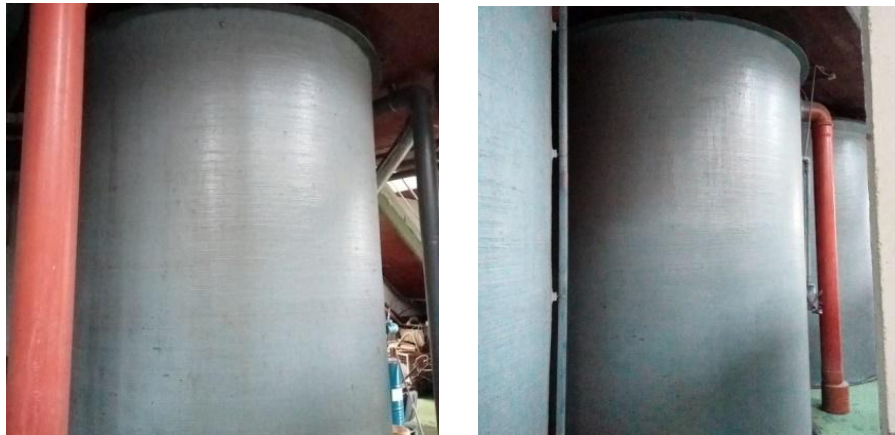
Figura 7. Depósito de homoxeneización N°1 (esquerda) e depósito de homoxeneización N°2 (dereita)
