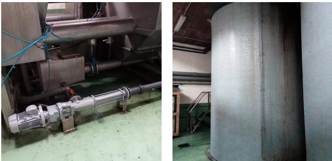
Figura 18. Bomba de purga helicoidal (esquerda) e depósito de PRFV de lodos (dereita)
