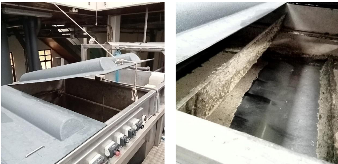
Figura 14. Detalle da cuberta do sistema de desodorización (esquerda) e detalle da varredora de cadea-piñón (dereita)
