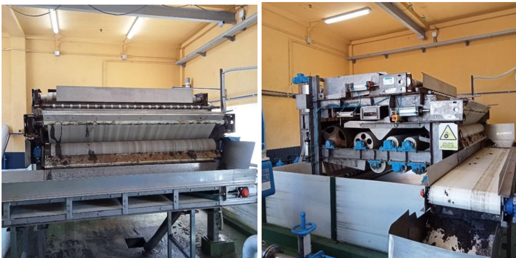
Figura 36. Vista frontal (esquerda) e lateral (dereita) do filtro banda
