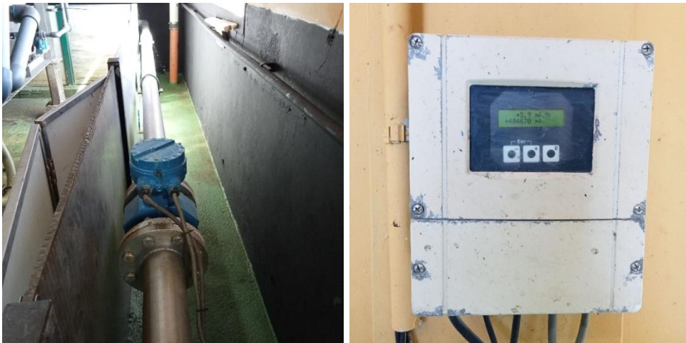
Figura 35. Vista xeral do caudalímetro a deshidratación (esquerda) e do seu transmisor (dereita)
