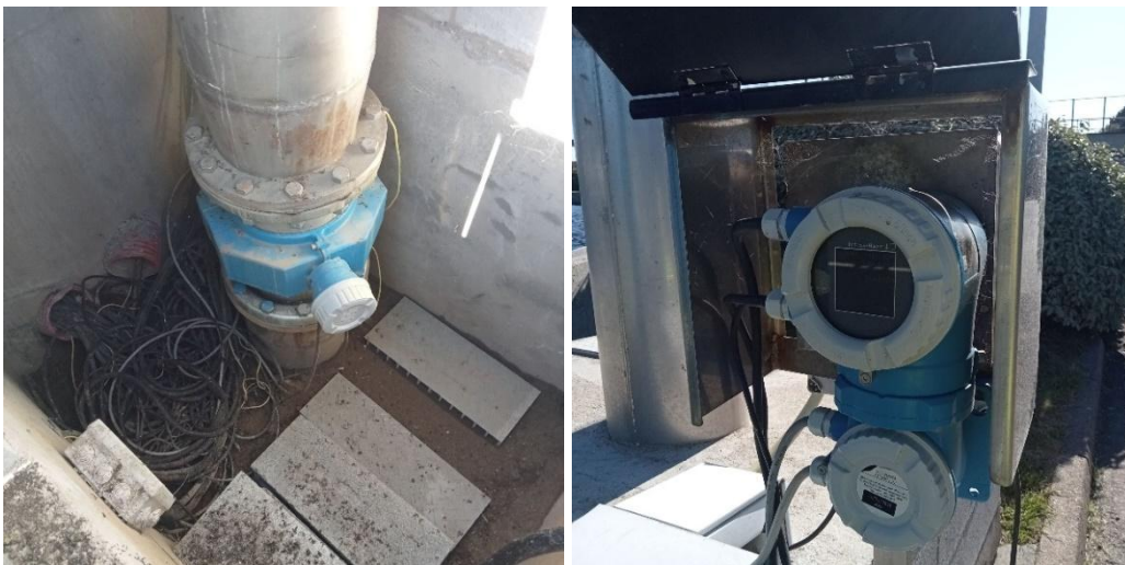
Figura 30. Vista xeral do caudalímetro de recirculación (esquerda) e do seu transmisor (dereita)
