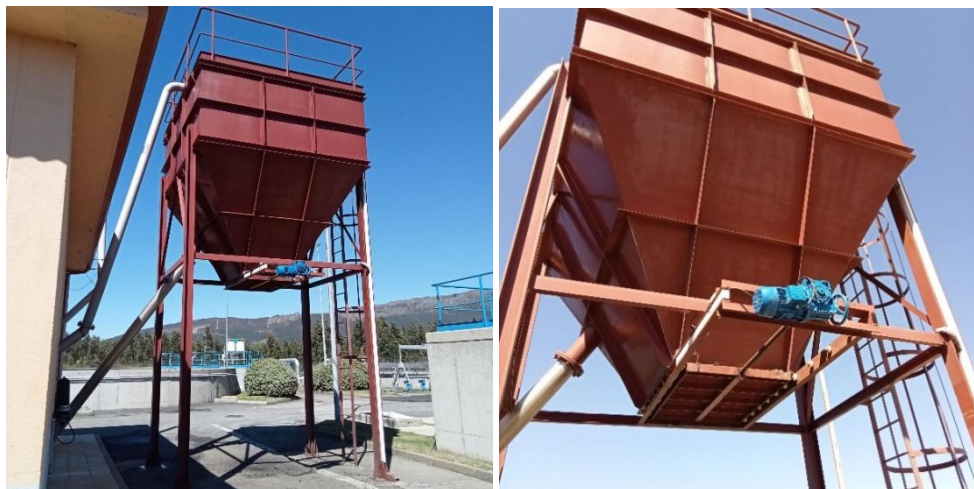
Figura 41. Vista xeral do silo de lodos (esquerda) e detalle da súa comporta talladeira (dereita)
