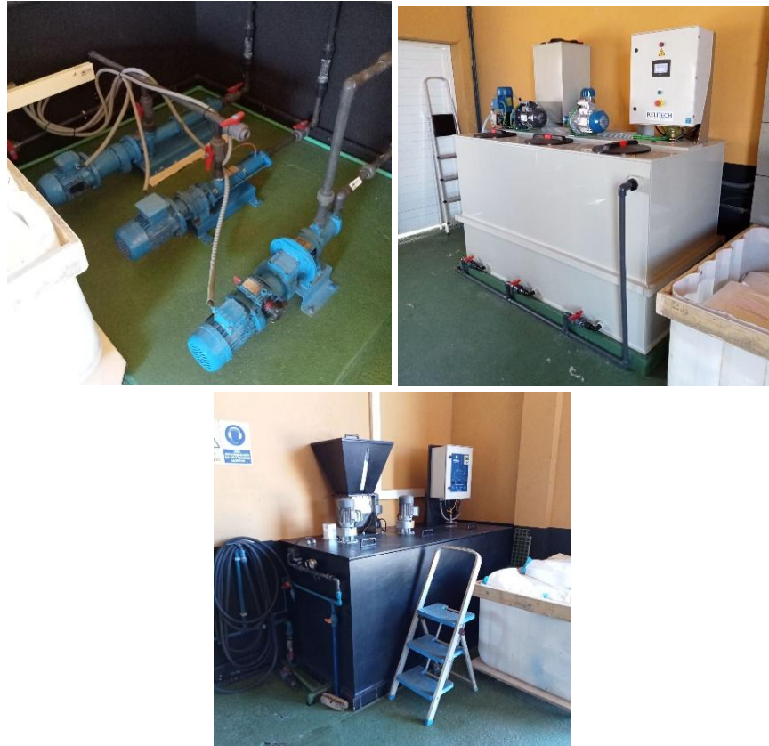
Figura 40. Vista xeral das bombas dosificadoras de polielectrolito (esquerda), así como do equipo de preparación automático de polielectrolito mixto (centro) e sólido (dereita)
