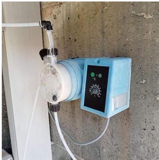
Figura 22. Vista da bomba dosificadora de hipoclorito sódico diluído
