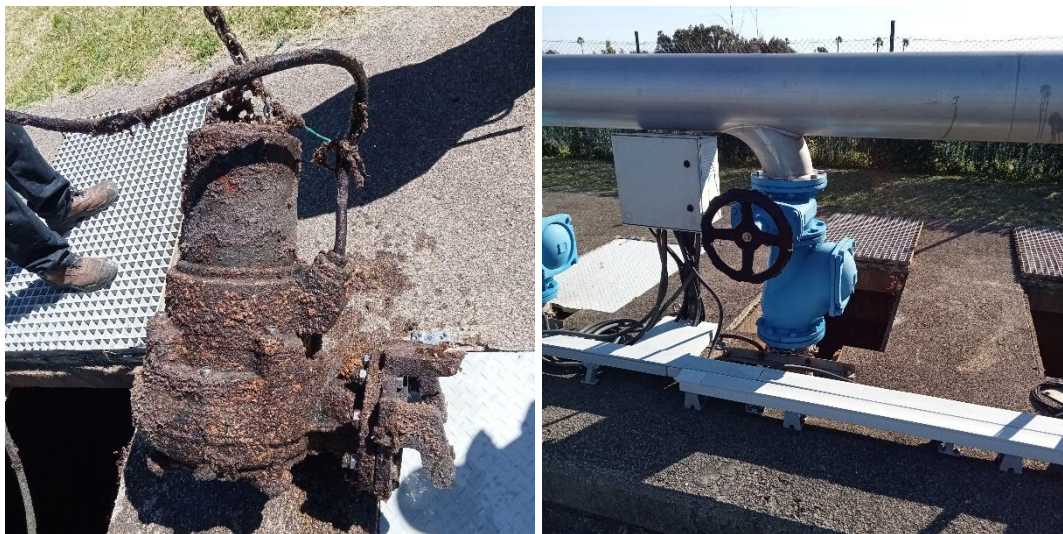
Figura 27. Vista da bomba a emisario 2 (esquerda) e da súa valvulería na impulsión (dereita)
