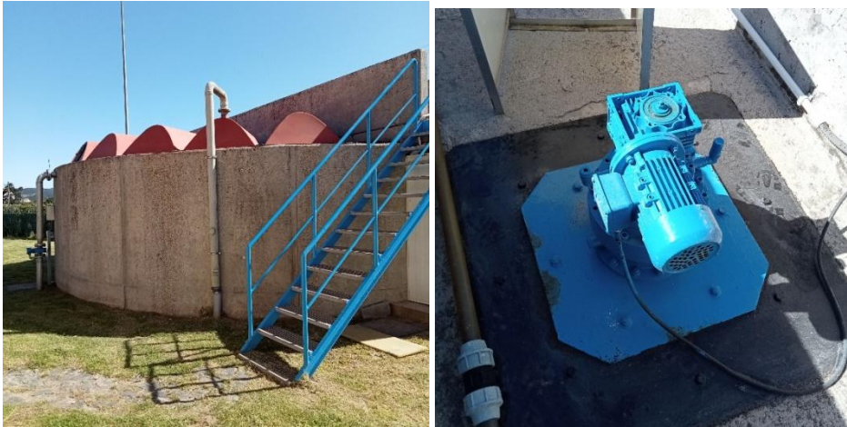
Figura 33. Vista xeral do espesador de lodos (esquerda) e do seu motorreductor (dereita)
