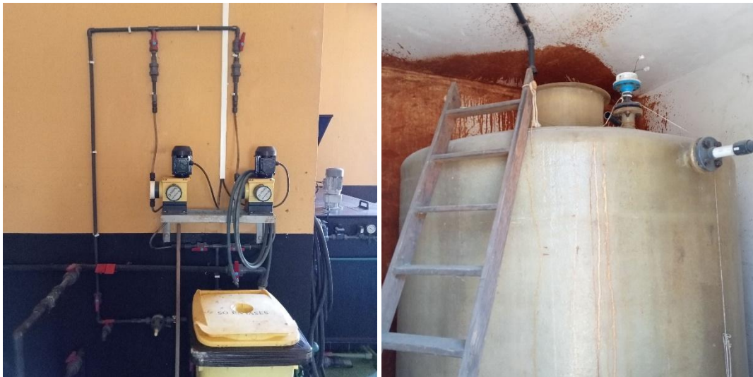
Figura 21. Vistas das bombas dosificadoras (esquerda) e do depósito de PRFV (dereita)
