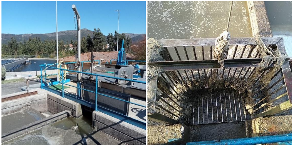
Figura 9. Vista xeral da entrada ao desareador-desengraxador (esquerda) e do cestón (dereita)
