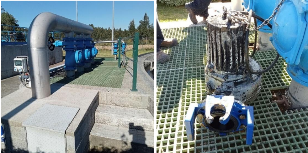
Figura 29. Vista xeral do bombeo de recirculación (esquerda) e dunha das bombas (dereita)
