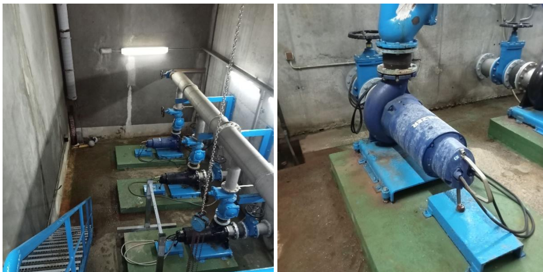
Figura 5. Cámara seca do bombeo da marxe dereita (esquerda) e bomba 1 (dereita).
