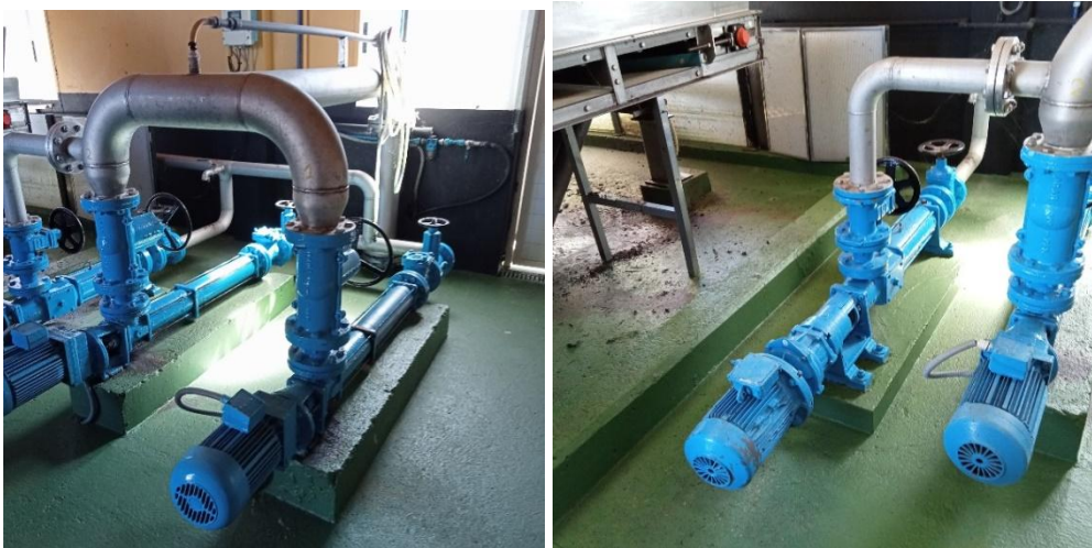
Figura 34. Vista xeral do bombeo a deshidratación: bombas 1 e 2 (esquerda) e bomba 3 (dereita)
