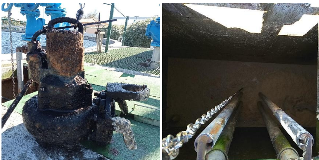
Figura 24. Vista dunha das bombas de flotantes (esquerda) e do pozo do bombeo (dereita)
