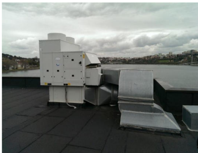
Figura 7 Equipo de climatización.
