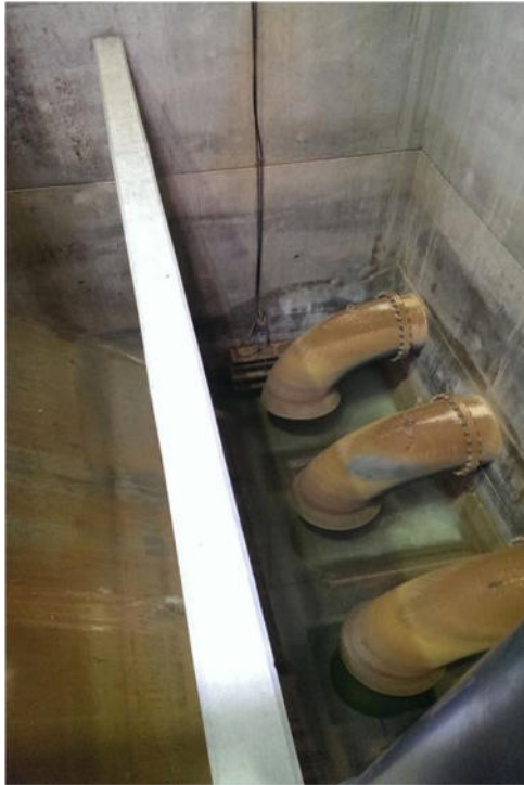
Figura 5 Comporta de separación das cámaras de aspiración.
