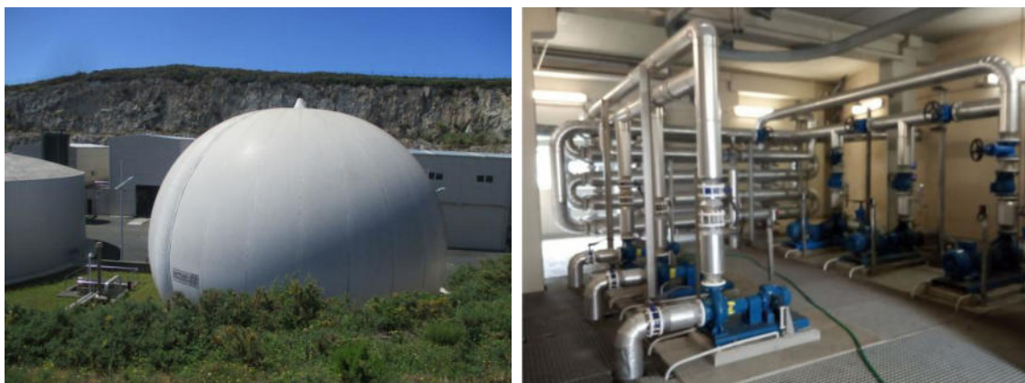
Figura 29 Gasómetro (esquerda) e intercambiador de calor (dereita).
