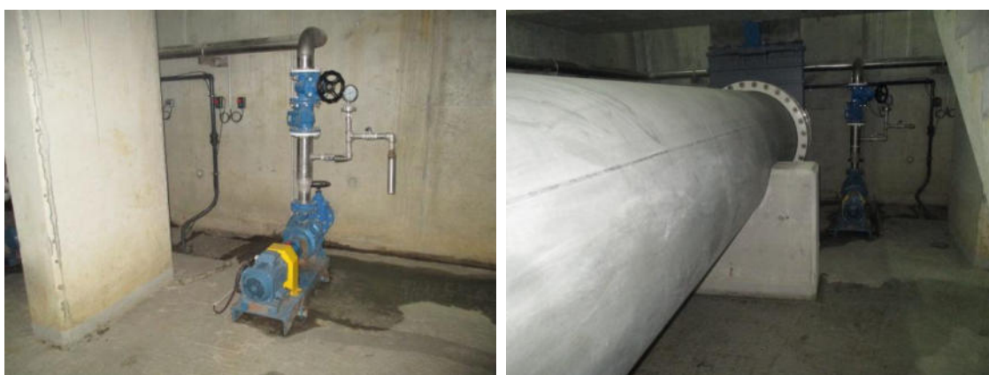
Figura 11 Bombeo de extracción de areas da cámara de carga (esquerda) e canalizacións de conexión da cámara de carga e do pozo de bombeo de cabeceira (dereita).
