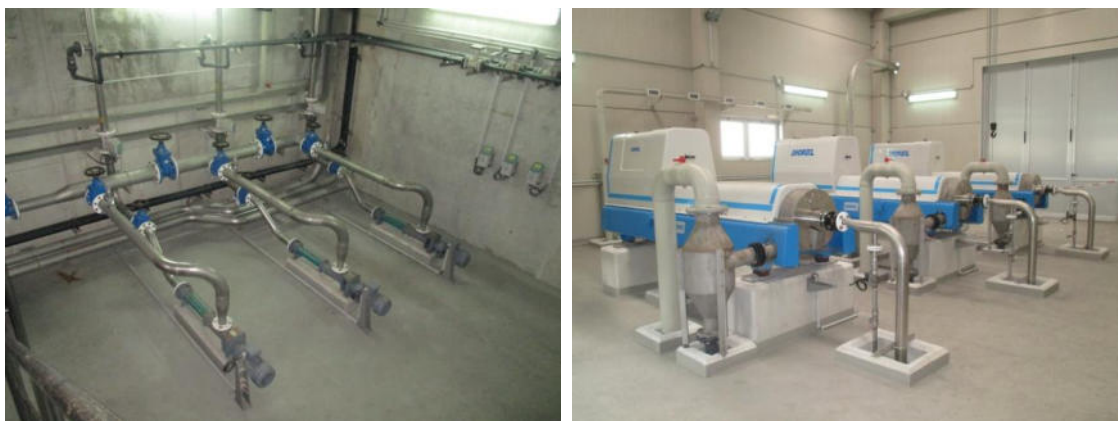
Figura 26 Bombeo a deshidratación (esquerda) e vista xeral das centrifugas (dereita).
