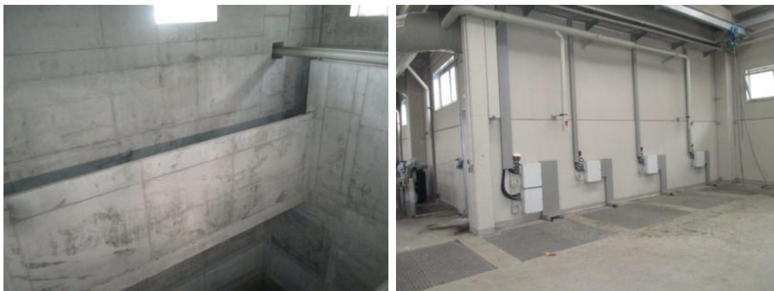
Figura 13 Vertedoiro de cámara de carga (esquerda) e bombas de bombeo de cabeceira (dereita).
