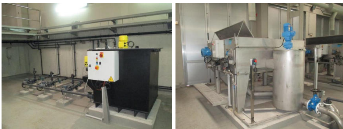
Figura 24 Preparación e dosificación de polielectrolito a predeshidratación (esquerda) e predeshidratación (mesa espesadora) (dereita).
