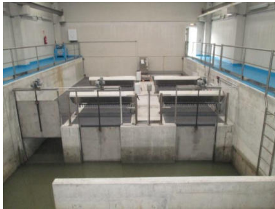
Figura 21 Vista xeral da desinfección UV.
