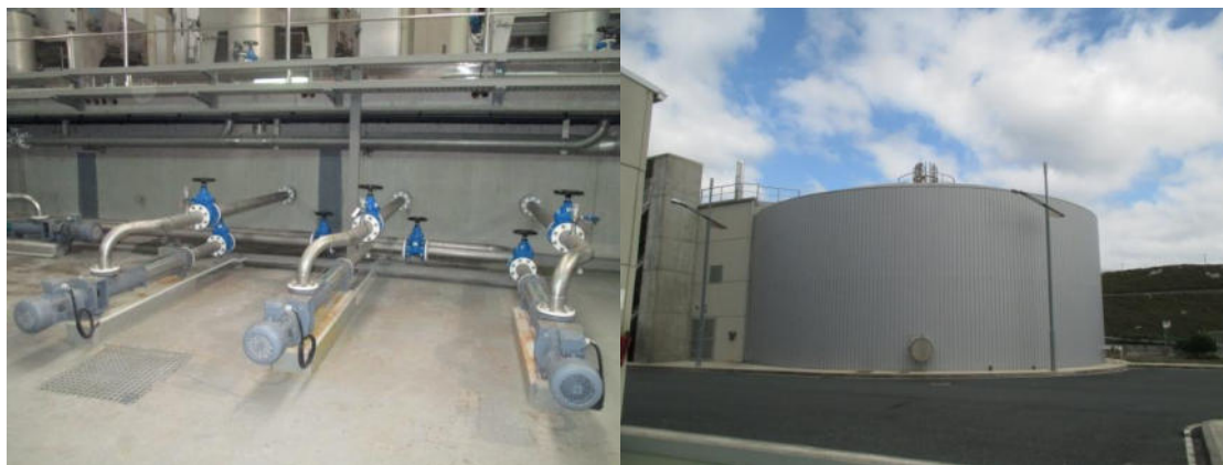
Figura 25 Bombeo de lodos a dixestión (esquerda) e dixestor anaerobio (dereita).
