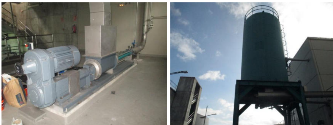
Figura 28 Bombeo de lodos deshidratado ao silo (esquerda) e silo de lodos deshidratado (dereita).
