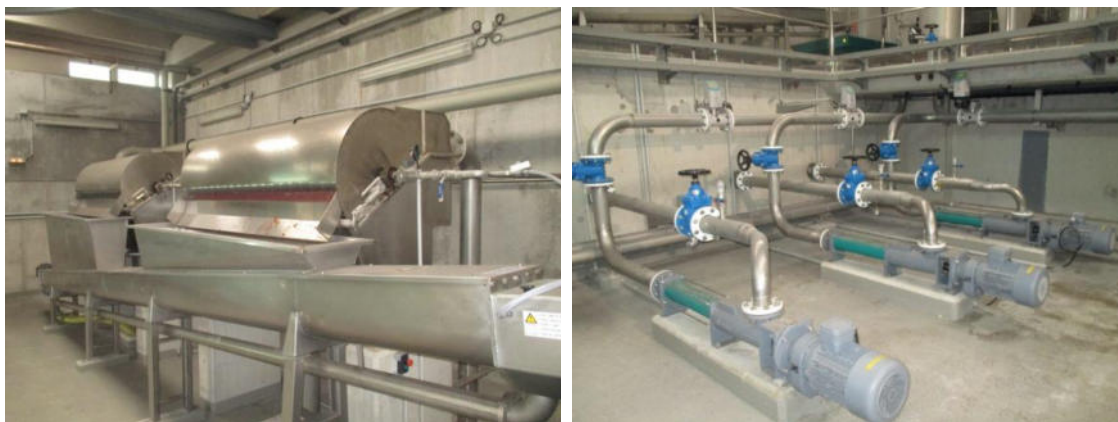
Figura 23 Rotacribas de lodos (esquerda) e vista do bombeo a espesamento (dereita).
