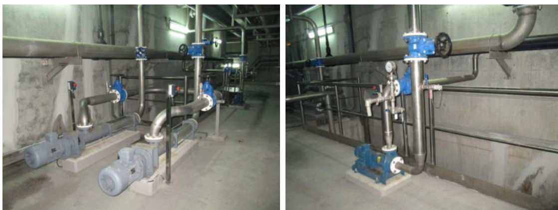
Figura 18 Bomba de lodos da decantación primaria (esquerda) e bomba de flotantes da decantación primaria (dereita).
