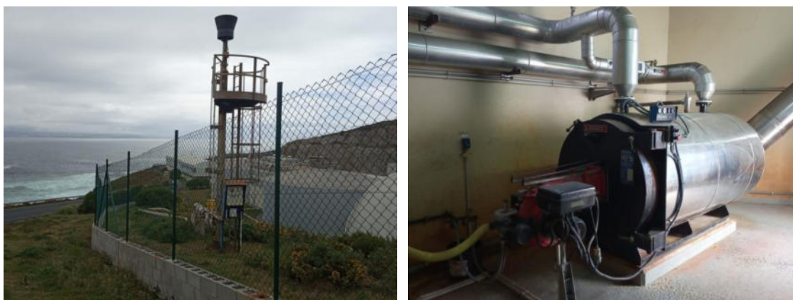
Figura 30 Antorcha de biogás (esquerda) e caldeira de biogás (dereita).
