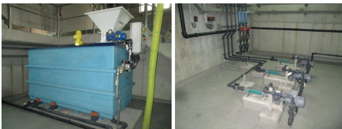
Figura 27 Preparación de polielectrolito para deshidratación (esquerda) e bombas dosificadoras de polielectrolito para deshidratación (dereita).
