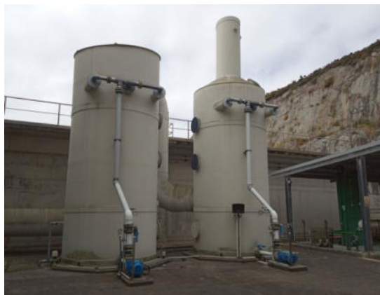
Figura 31 Torres de lavado - desodorización.
