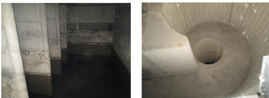
Figura 12 Vista xeral do pozo de bombeo de cabeceira (esquerda) e vórtice de descarga do bypass da cámara de carga (dereita).
