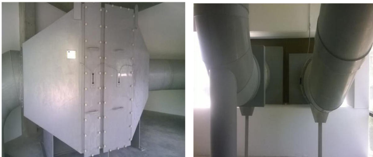
Figura 6 Filtro de carbón activo e ventilador axial.
