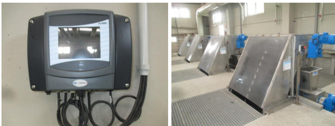
Figura 14 Sonda multiparamétrica de entrada (medición de pH, condutividade, turbidez e temperatura) (esquerda) e canles de desbaste equipadas con cribas (dereita).
