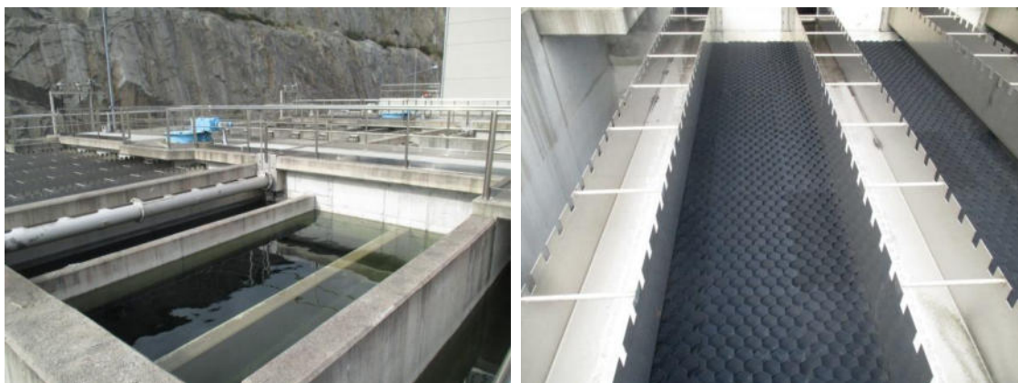
Figura 16 Decantadores primarios (esquerda) e vista de detalle das lamelas dos decantadores primarios (dereita).
