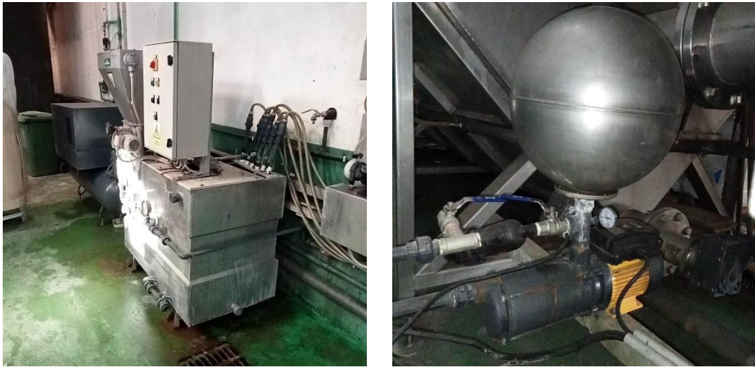
Figura 17. . Estación de preparación de polielectrolito (esquerda) e bombeo de auga de servizo (dereita)
