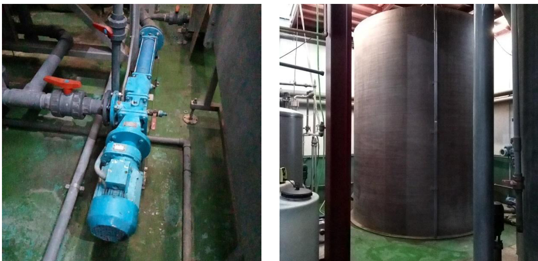
Figura 15. . Bomba de parafuso helicoidal de purga de lodos (esquerda) e depósito PRFV acumulador de lodos (dereita)
