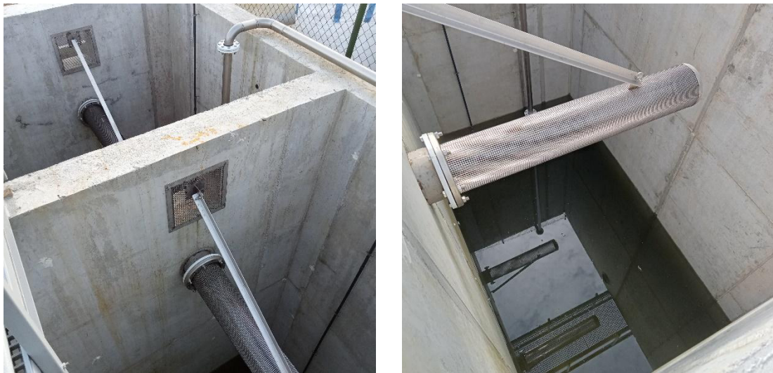
Figura 7. Interior dun dos compartimentos do reactor biolóxico e o colector de malla para a evacuación das augas
