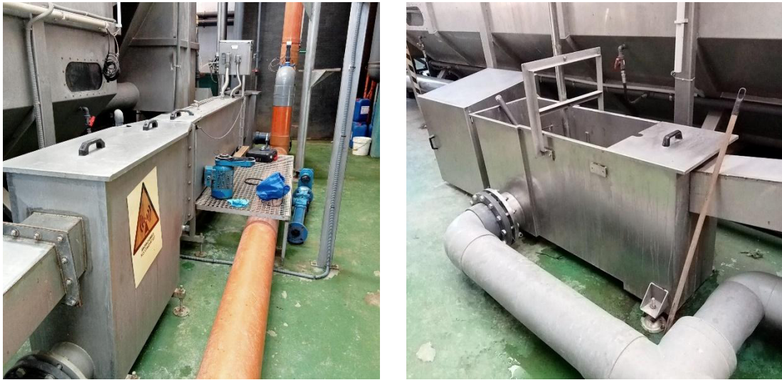
Figura 14. Equipo de desinfección UV
