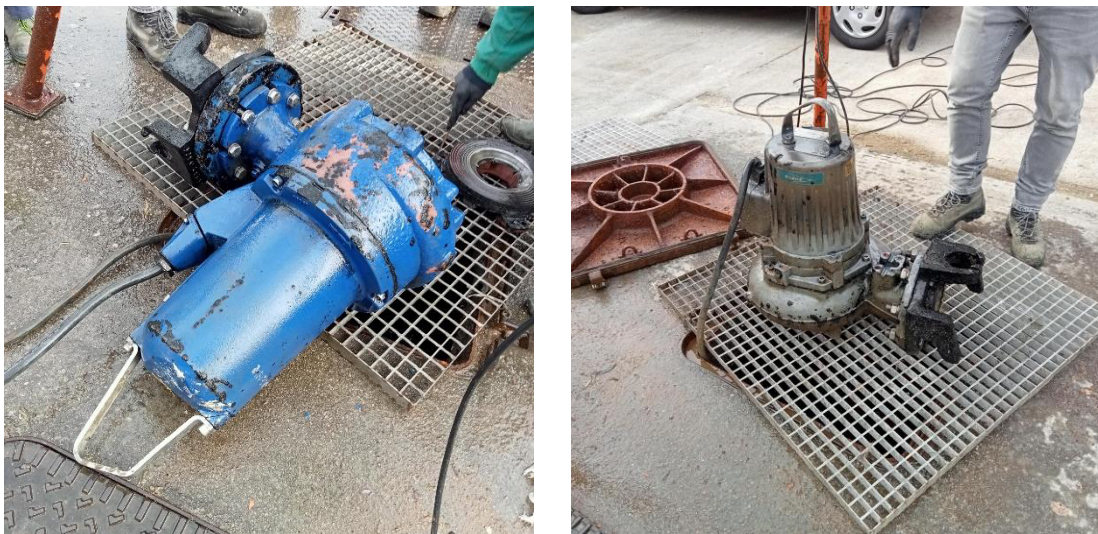
Figura 3. Bomba de cabeceira Nº1 (esquerda) e bomba de cabeceira Nº2 (dereita)
