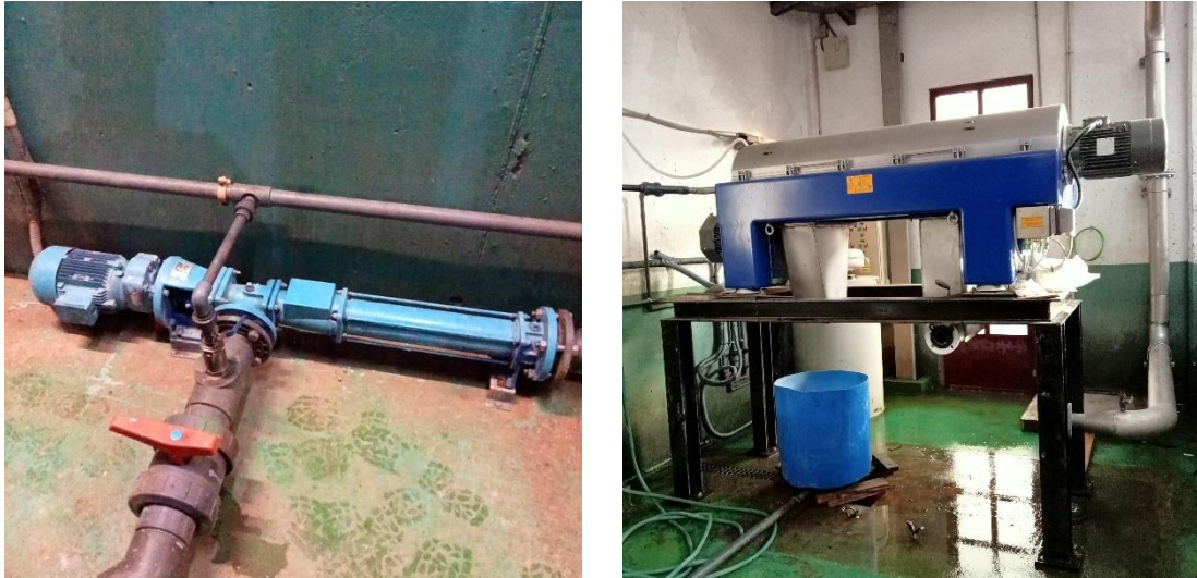
Figura 16. Bomba de parafuso helicoidal de lodo a deshidratación (esquerda) e centrífuga de lodos (dereita)
