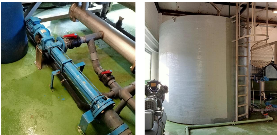
Figura 16. Bomba de purga de lodos de parafuso helicoidal (esquerda) e depósito PRFV de lodos (dereita)
