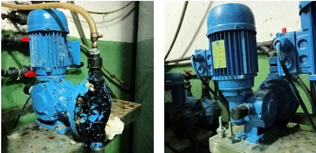
Figura 13. Bomba de coagulación (esquerda) e bomba de floculación (dereita)
