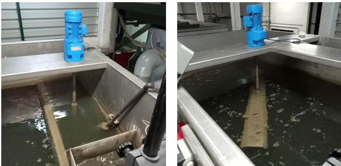
Figura 12. Cámara de coagulación (esquerda) e cámara de floculación (dereita)
