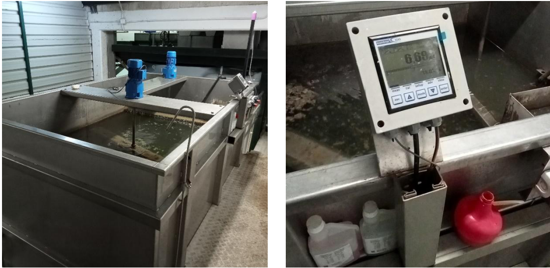
Figura 11. Vista xeral das cámaras de coagulación e floculación (esquerda) e medidor de pH (dereita)
