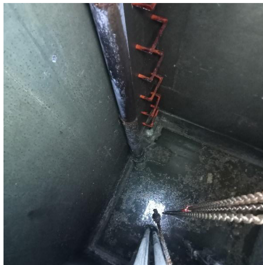
Figura 5. Vista xeral do pozo do bombeo de cabeceira
