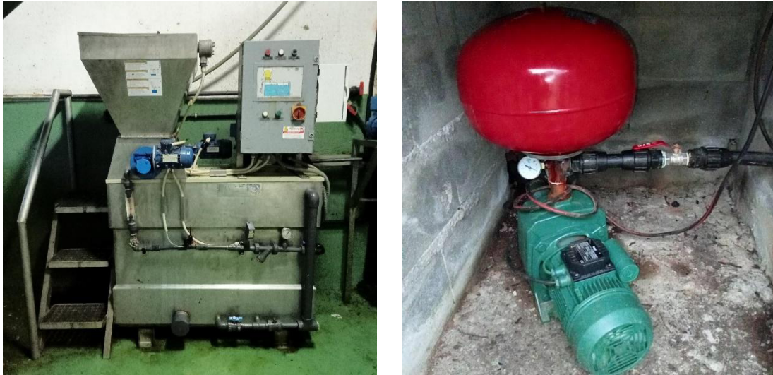
Figura 19. Estación de preparación de polielectrolito (esquerda) e bombeo de captación auga industrial (dereita)
