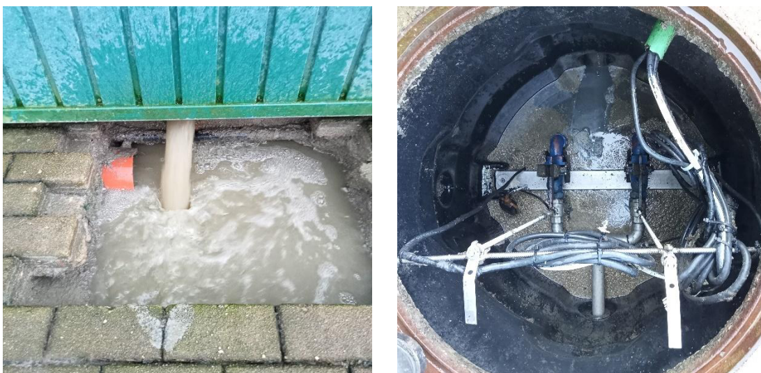
Figura 18. Arqueta de recollida de auga procedente de deshidratación e lavado (esquerda) e pozo con bombas centrifugas somerxibles de drenaxe (dereita)
