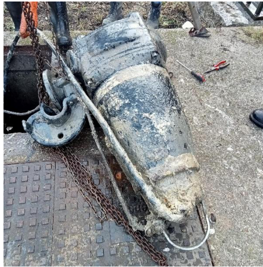
Figura 7. Bomba de cabeceira N°1 (superior esquerda), N°2 (superior dereita) e N°3 (inferior)
