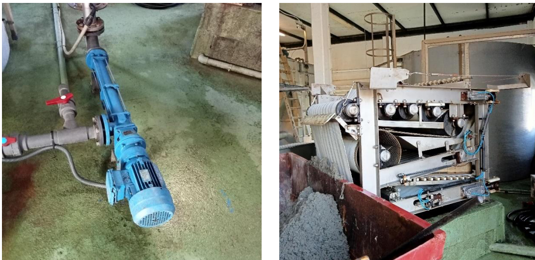
Figura 17. Bomba de lodos de parafuso helicoidal a filtro banda (esquerda) e vista xeral de filtro banda (dereita)
